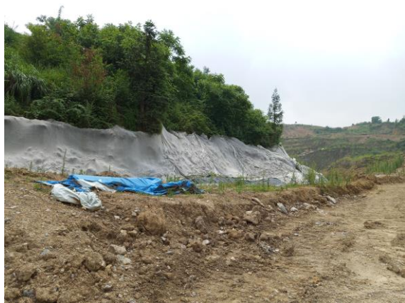
采矿区边坡遮盖措施
