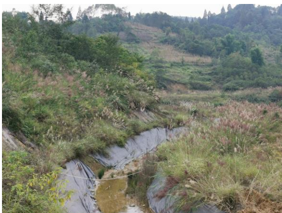
排土场区截洪沟
